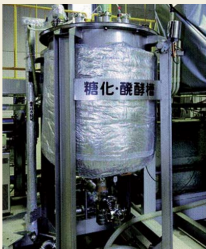
バイオエタノール生成プラントの一部
